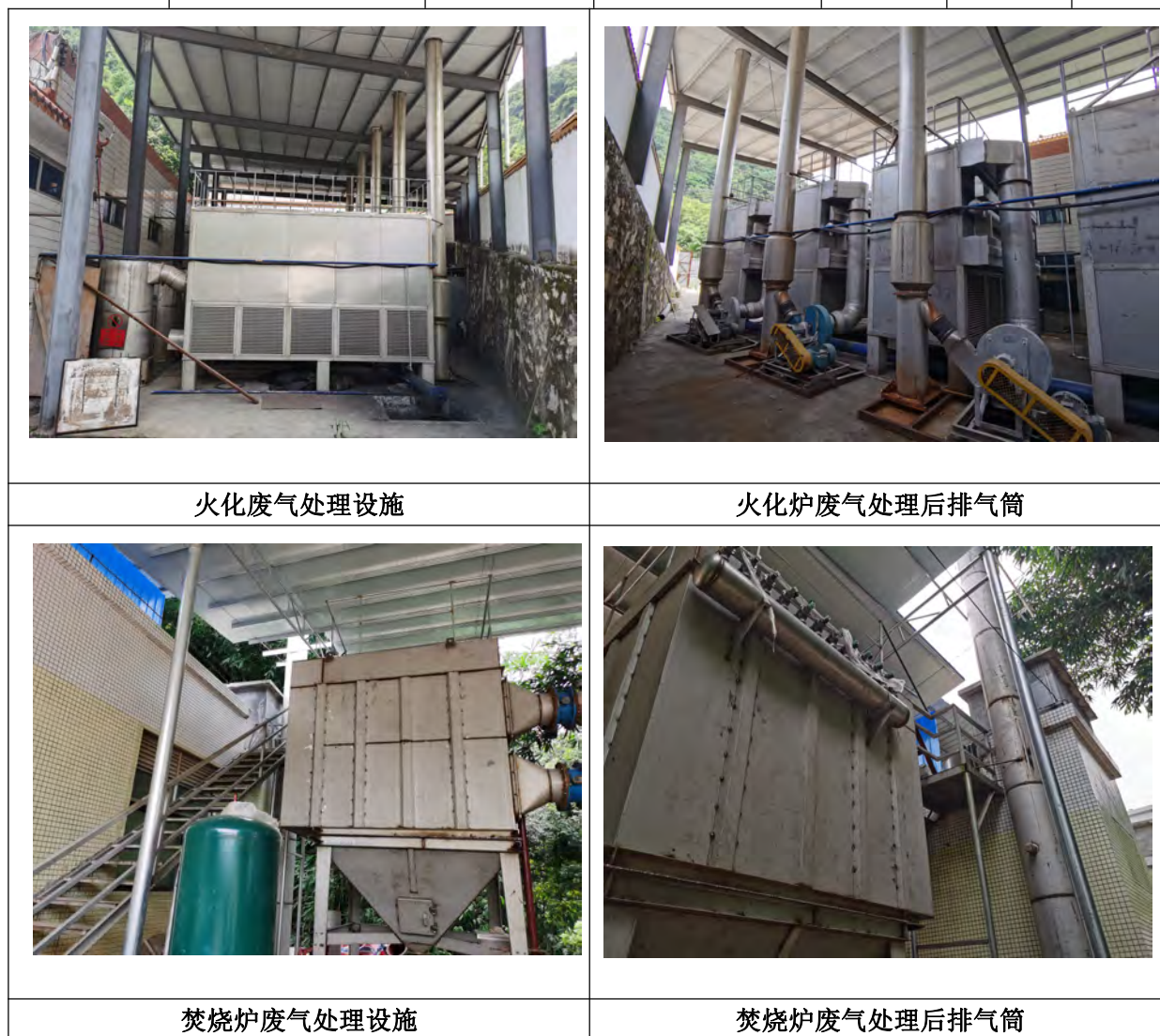
图 4.1-3 废气治理设施照片
