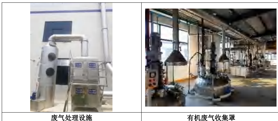
图4.1-3 废气治理设施照片
